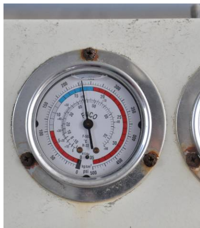
圖 9 清洗前設備使用電流 146.5A，高壓 16.4 kg/cm 2
