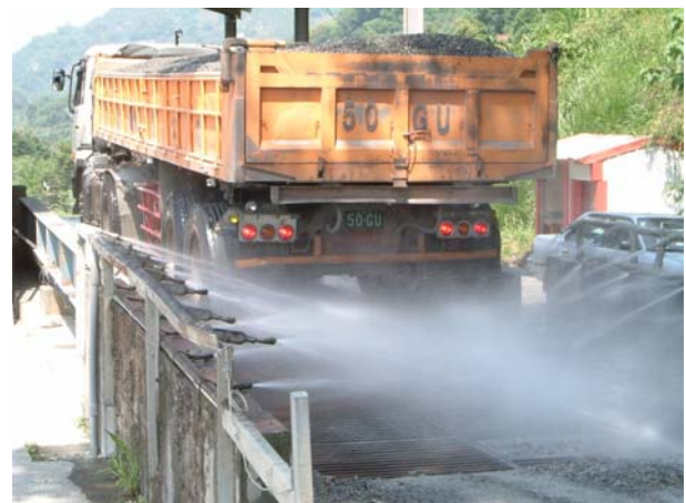
圖 9 自動洗車設備
