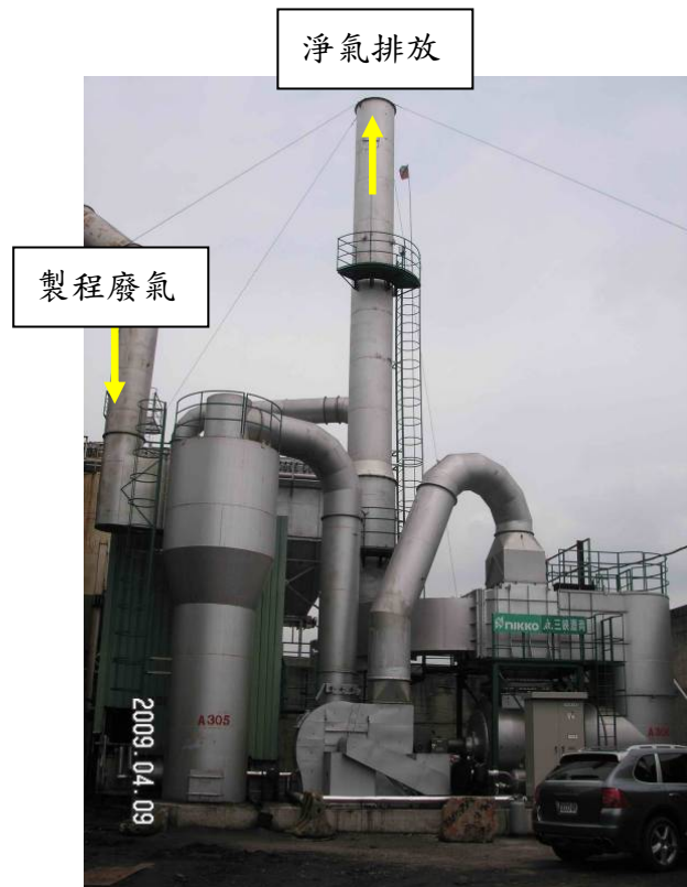
圖 3 完成設置之廢氣焚化爐
