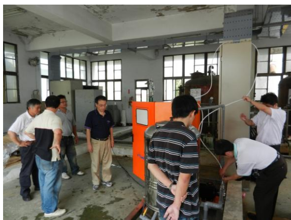
圖 2 臭氧系統安裝情形
