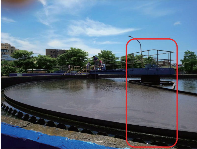
圖 4 污泥管的進流口位在刮泥機驅動平台底部的水中，無法使用量測儀器
