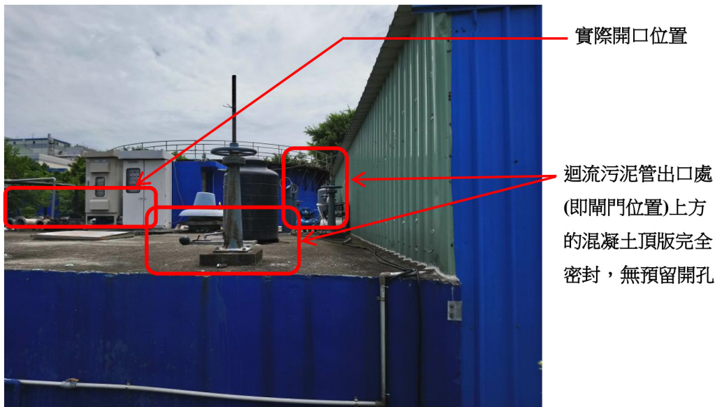
圖 5 污泥管出流口位在迴流污泥井的閘門底下，其上方的 RC 頂版未設任何開孔
