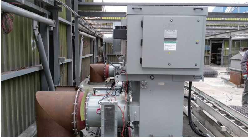
圖 11 高頻變壓整流器安裝完成
